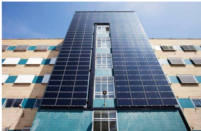
Fig. 1.24 SFCR en edificación.
